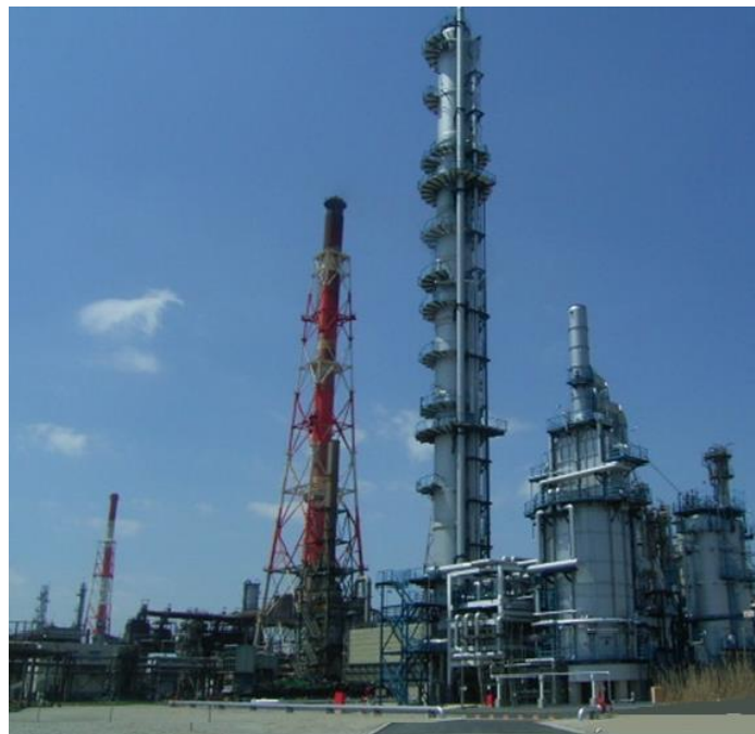
混合キシレン回収装置
