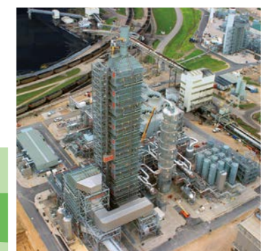
CO 2 回収プラント(米国テキサス州)
