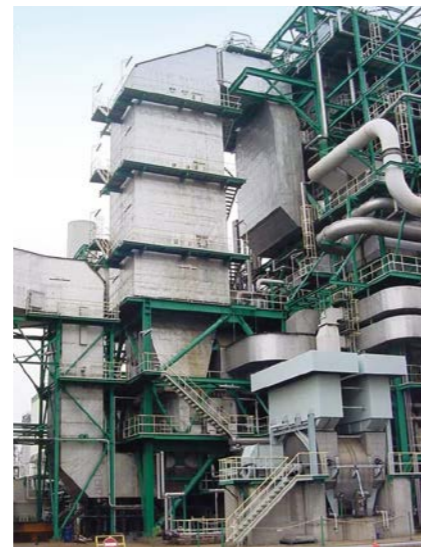
排煙脱硝装置
