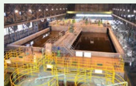
豊羽鉱山 本山坑廃水処理場の様子
