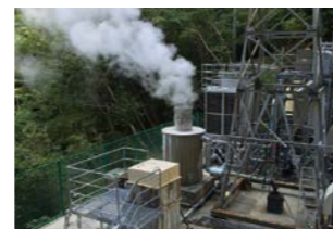
下田温泉バイナリー発電所
